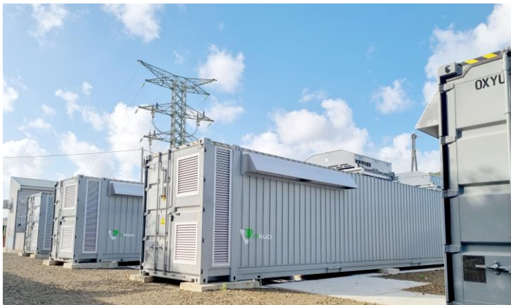
BESS centralisé: 12MW/20MWh en Martinique
